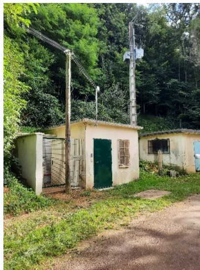
Transformateur sur poteau
